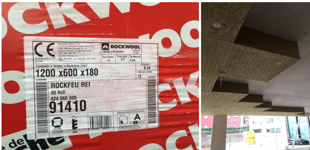
Isolant sous face de dalle RDC (laine de roche), sur parking
