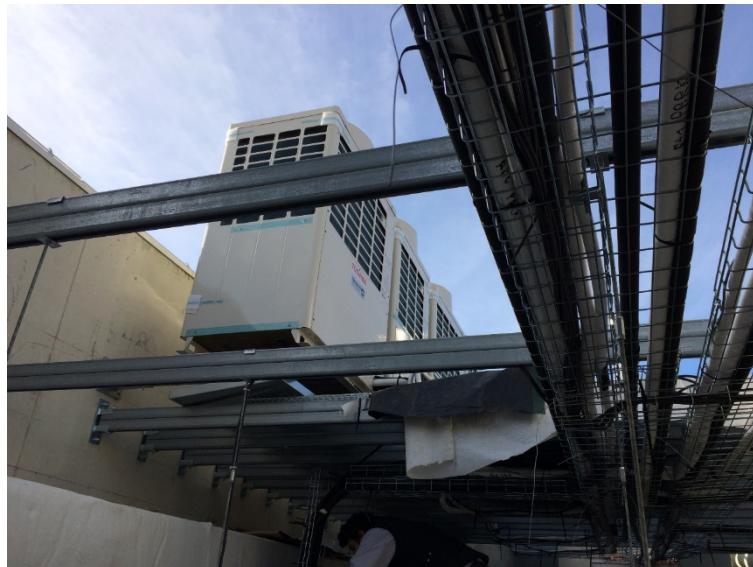
Groupes froids sur « mezzanine » dans la cour anglaise
