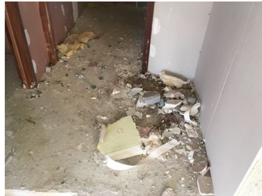
Problème récurrent de propreté de chantier
