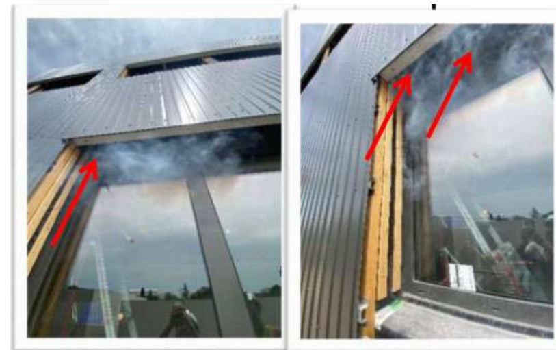
Recherche au fumigène sur bâtiment B : mise en évidence de fuite au niveau des liaisons entre parois et ouvrants façades ossature bois
