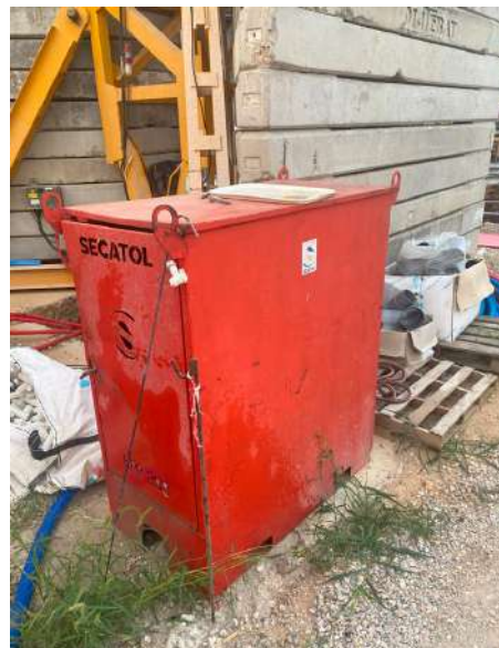
Coffret et bac de décantation de fût d'huile de décoffrage
