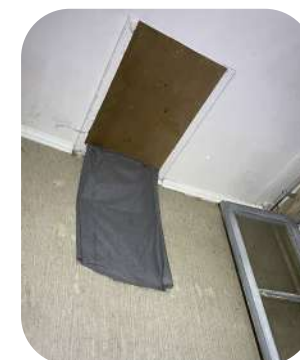
Filet antiretour placé sur une ouverture de plafond
