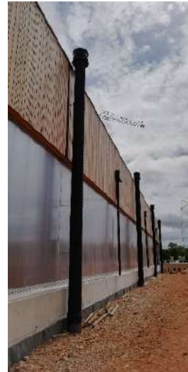
Gymnase - Façade Sud Bardage bois douglas + Danpalon
