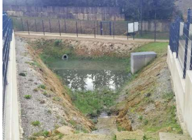
Bassin de rétention d'eau
